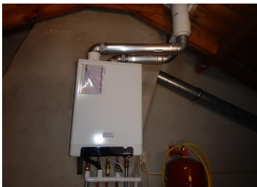
Cv-ketel niet asbestverdacht
