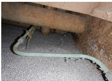
Bron 2 ontluchtingsbuis in kruipruimte
