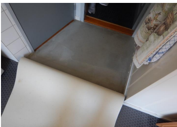
Beperking keukenvloer nieuwe egalinelag
