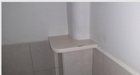
Detailfoto locatie standleiding
