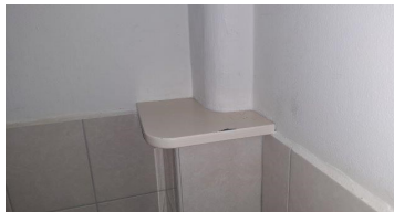
Detailfoto locatie standleiding
