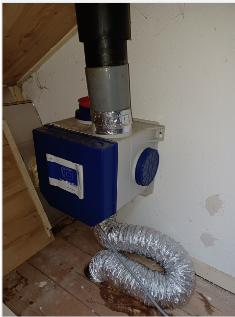
Ventilatiebox Itho Daalderop CVE ECO (na 1993)
