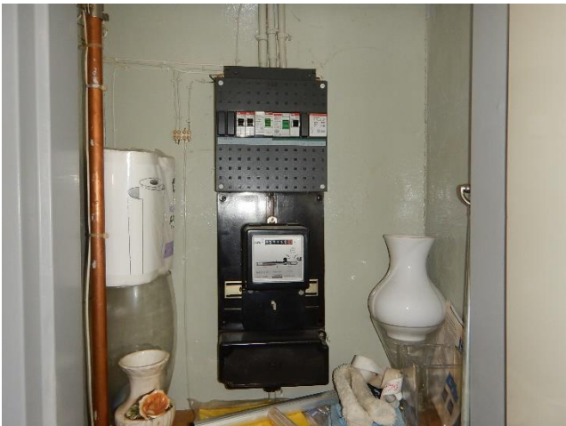
Elektra-installatie niet asbestverdacht
