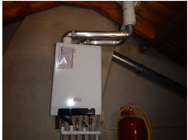
Cv-ketel niet asbestverdacht
