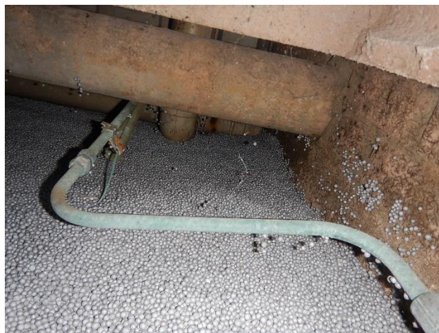
Bron 2 ontluchttingsbuis in kruipruimte
